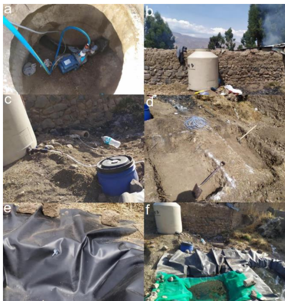
Fig.4.a.Sistema de Bombeo de agua residual, b. Dispensador/Sedimentador de agua residual c. Prototipo de Tanque Imhoff, d. Construcción de lagunas de estabilización en tierra, e. Revestimiento con Geomembrana, f. Sistema general con Nostoc commune .
